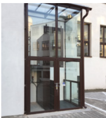
Zvislá plošina v presklenom ohradení
